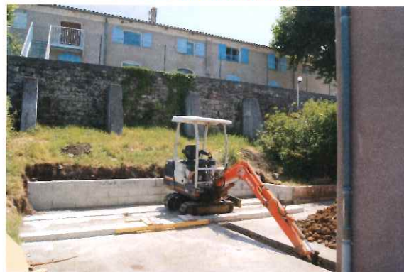
Travaux de mise aux normes au groupe scolaire des Mines. Mise en place d'un système de chauffage au bois. Emplacement local pour la chaudière à bois déchiqueté.
